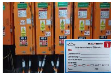
Implementación los TAG de Identificación de los equipos que energizan en los Tableros eléctricos
