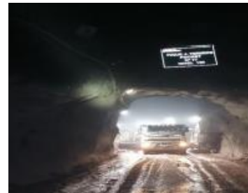
Pocket de descarga Nivel 4175 N 78 cable eléctrico en el hastial izquierdo fuera del alcance de la tolva levantada por volquete
